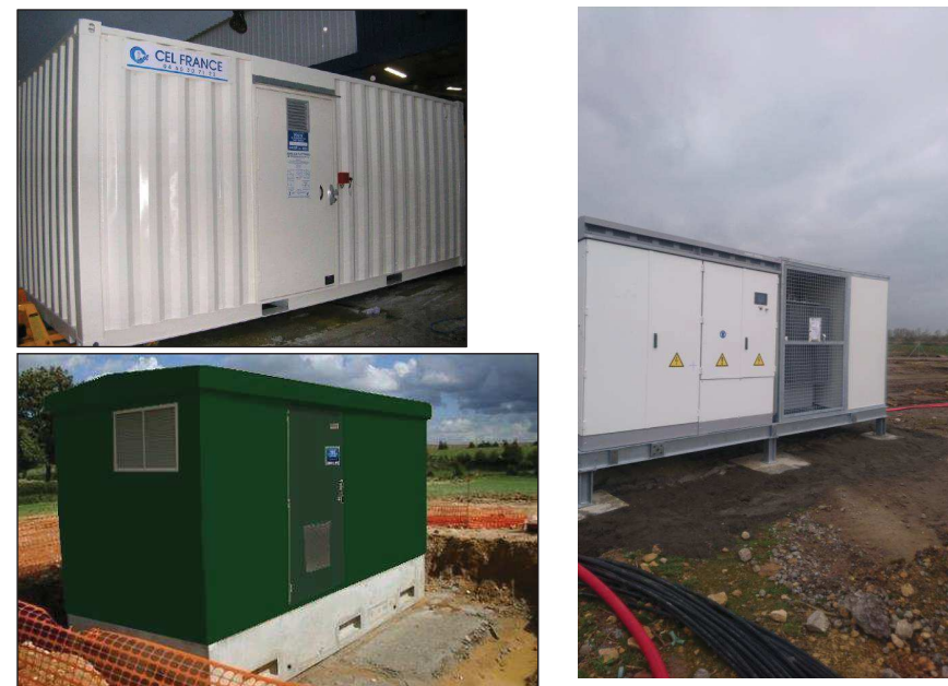
Figure 29 : Exemple de poste électrique ; à droite poste outdoor (sans fondation), à gauche en haut poste métallique (sans fondation) et en bas poste en béton (avec fondation)
